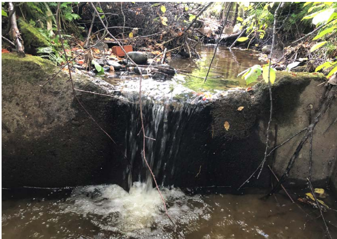
Foto 2: Ørret oppvandet fra Gaula passerer både stikkrenne under jernbane, veikulvert og lukking under industriområdet, men stoppes av en murt betongkant rett ovenfor industriområdet. Foto: Morten Andre Bergan, NINA.
