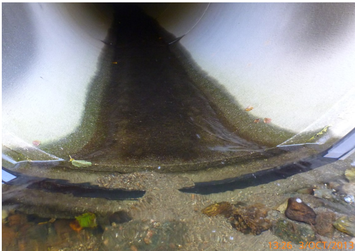
Figur 76. Kulvertinngang under Fv 231 i Karlsengbekken. Svært lite vanndyp i kulverten ved lave og middels vannføringer. Foto hentet fra Bergan 2014a. (Foto: Morten Andre Bergan)
