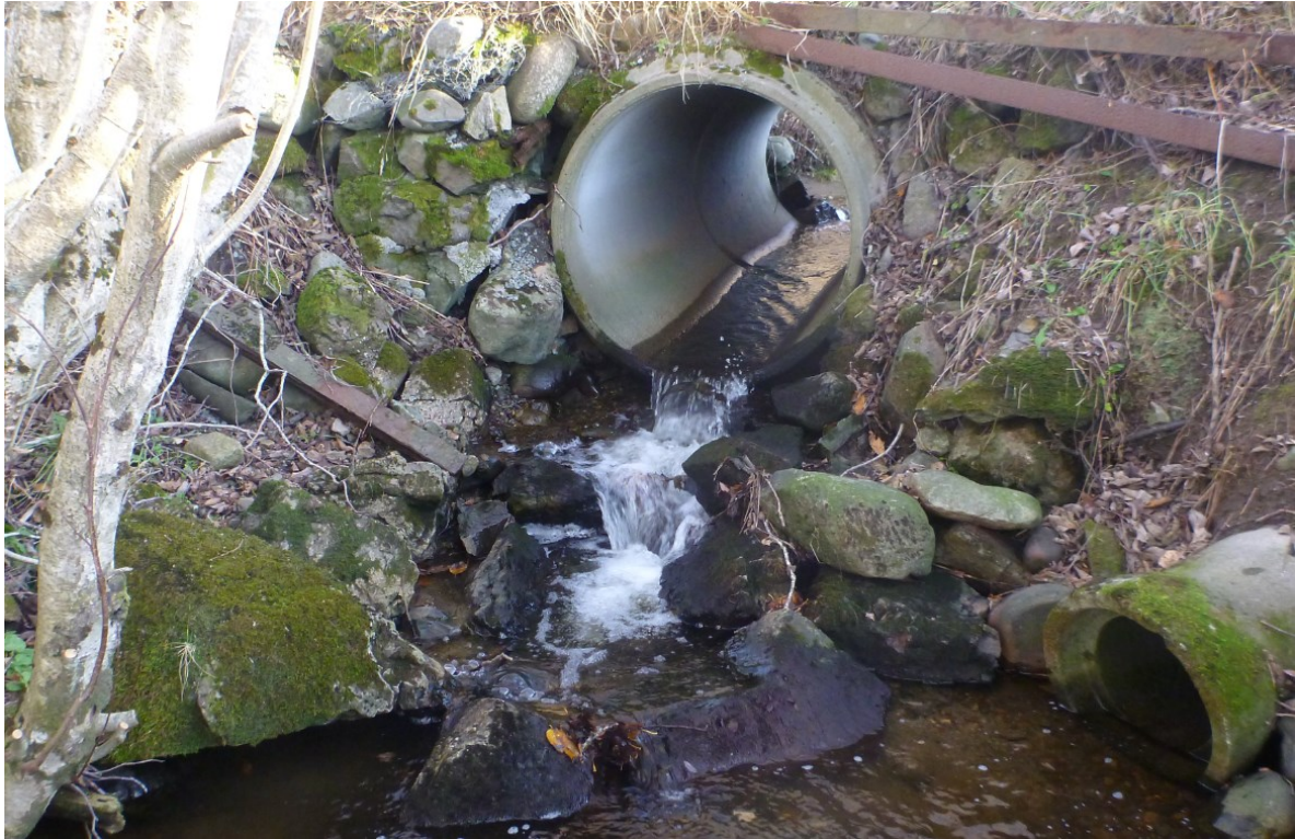
Figur 35. Kulvert under privat bilvei i Karlsengbekken ved Fjellstad og Solheim (J). Foto: Morten Bergan.
