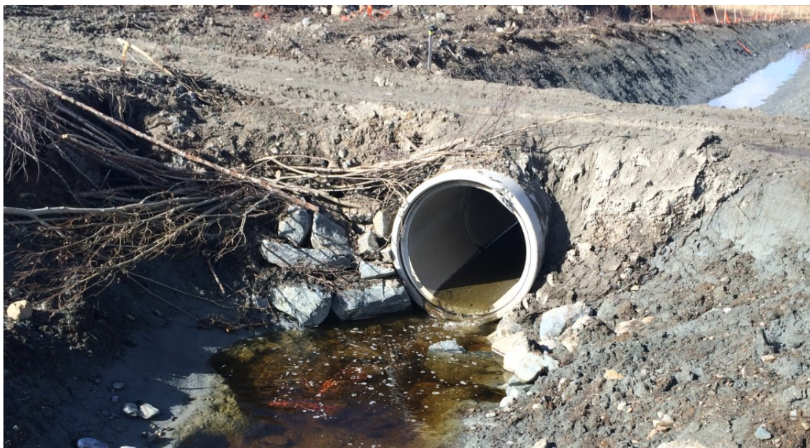
Figur 26. Nyetablert kulvert (C) i tiltaksområdet ved Rusasetvatnet. Fall ved utløp og lav vann- dybde burde vært unngått, selv på lav vannføring, men fisk kan passere ved vannføringer over middels. Foto: Morten Bergan.
