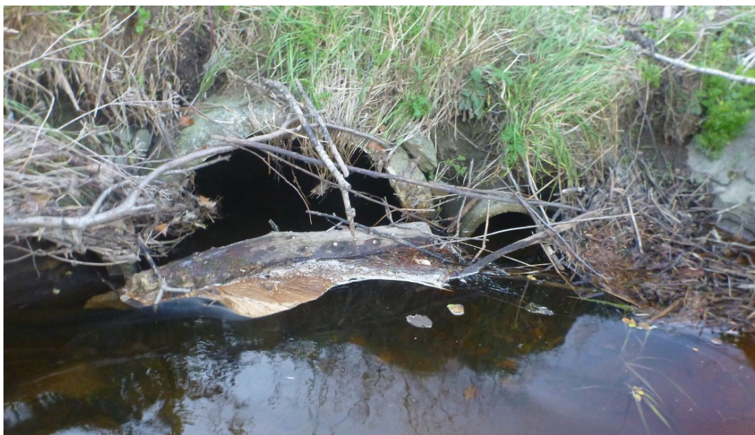
Figur 30. Nedsenket kulvert under traktorvei ved Vangen (G). Foto: Morten Bergan.
