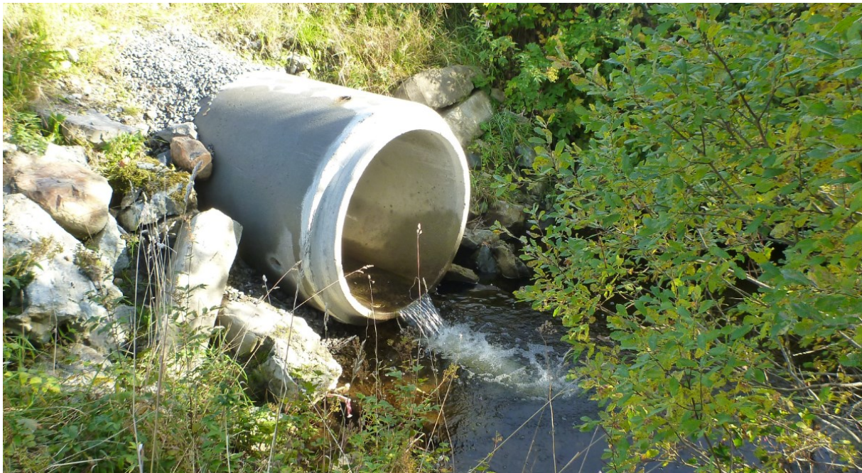
Figur 77. Kulvertutløp nedstrøms Fv 213 i Karlsengbekken. Sprang opp til kulvert på liten og middels vannføring. Foto hentet fra Bergan 2014a. (Foto: Morten Andre Bergan)
