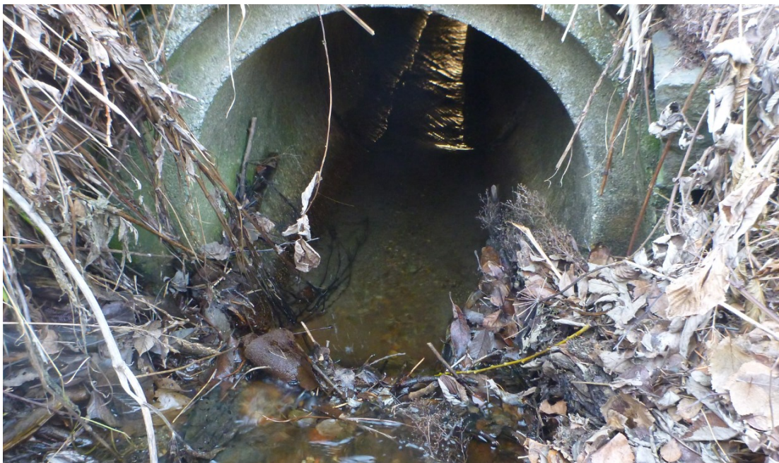
Figur 32. Kulvert under Fv 231 i navnløs sidebekk til Karlsengbekken (I). Foto: Morten Bergan.
