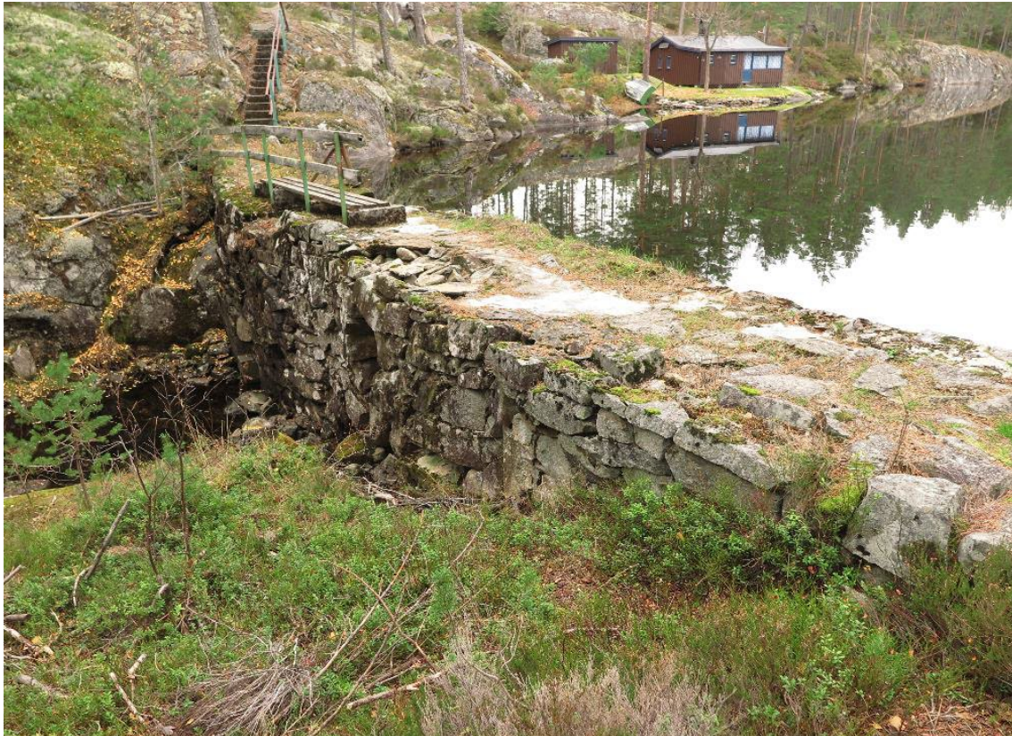
Figur 1: Dam ved Mortenstjern i Bingselvavassdraget.
