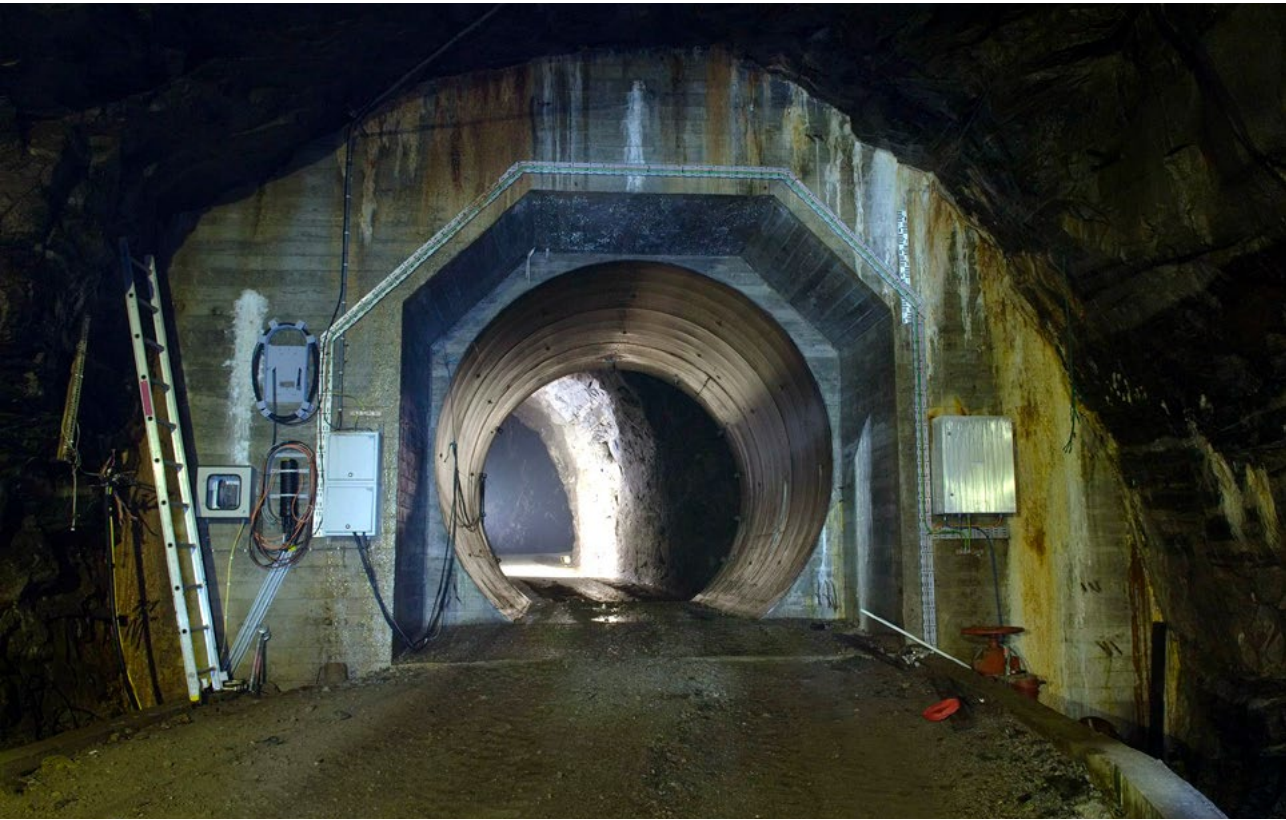
Tverrslagspropp sandfang, Tonstad kraftverk. Foto: Kai-Wilhelm Nessler
