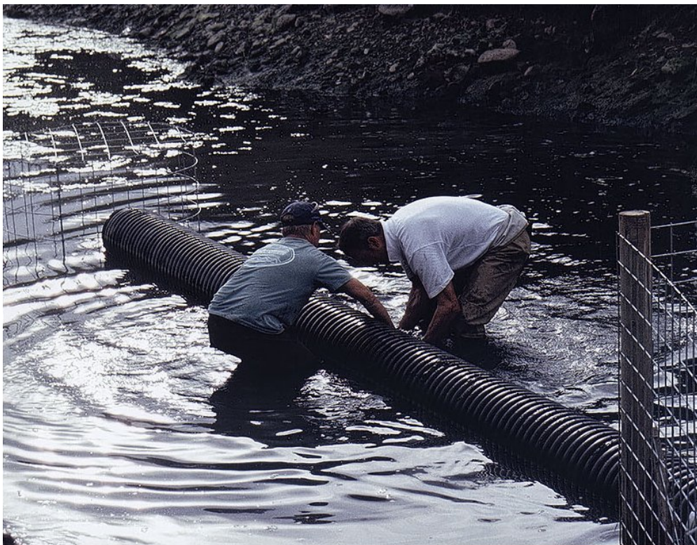
Figur 13.9 Bygging av kombinert for-dam og nettingsylinderfilter. C) Filter og rør settes på plass.
