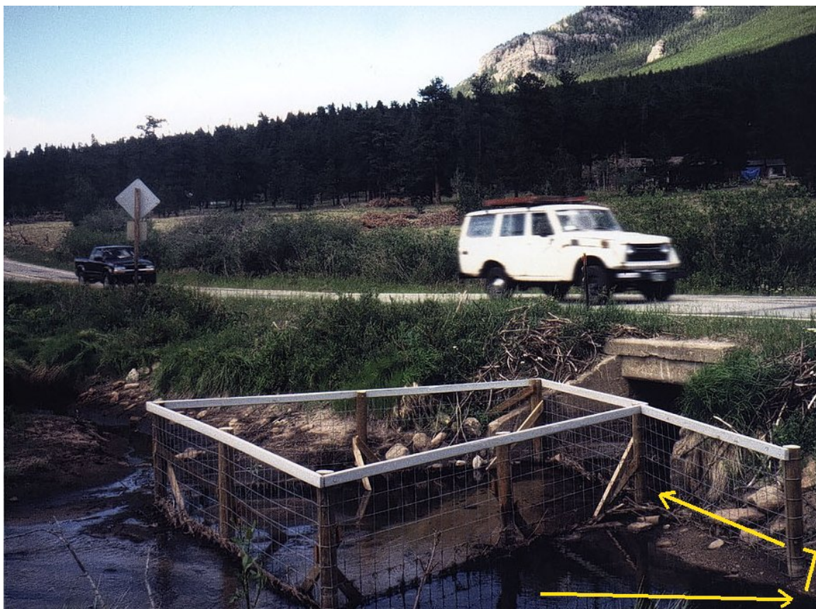
Figur 11.5 Beverport utformet som sti mellom en forlengelse av gjerdet mot stikkrennen, og veikanten. Den gule pilen indikerer beverens atkomstvei. NB! Metoden er effektiv i forhold til å forebygge innhenting av byggematerialer bare der terrenget passer; spesielt må veikanten være bratt. Foto: S. Lisle
