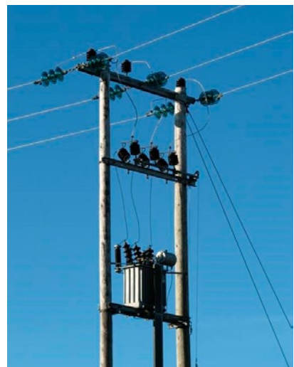
Stolpemonterte transformatorer i tilknytning til distribusjonsnettet er blant de strukturer som oftest forårsaker elektroksjonsulykker hos fugl pga. de korte avstandene mellom strømførende ledninger og/eller strømførende ledning og jordet del. Foto: Kjetil Bevanger
