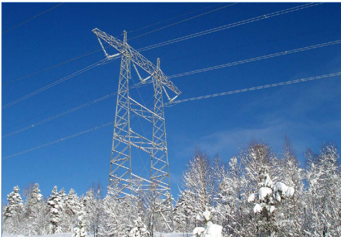
Standard portalmast, bæremast 420 kV duplex, v-kjeder i glass. (Foto: Statnett).
