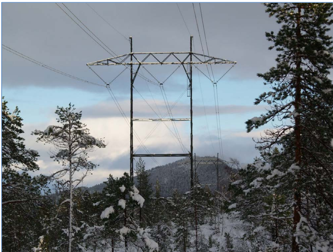
420 kV duplex, komposittisolatorer, maltemaster i vinterlandskap. (Foto: Statnett).
