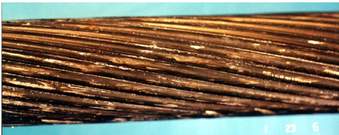
Figur 7. Stålaluminiumline med våtlakk. Spaltekorrosjon har oppstått under våtlakken, som har løst. Foto: S. Refsnæs.
